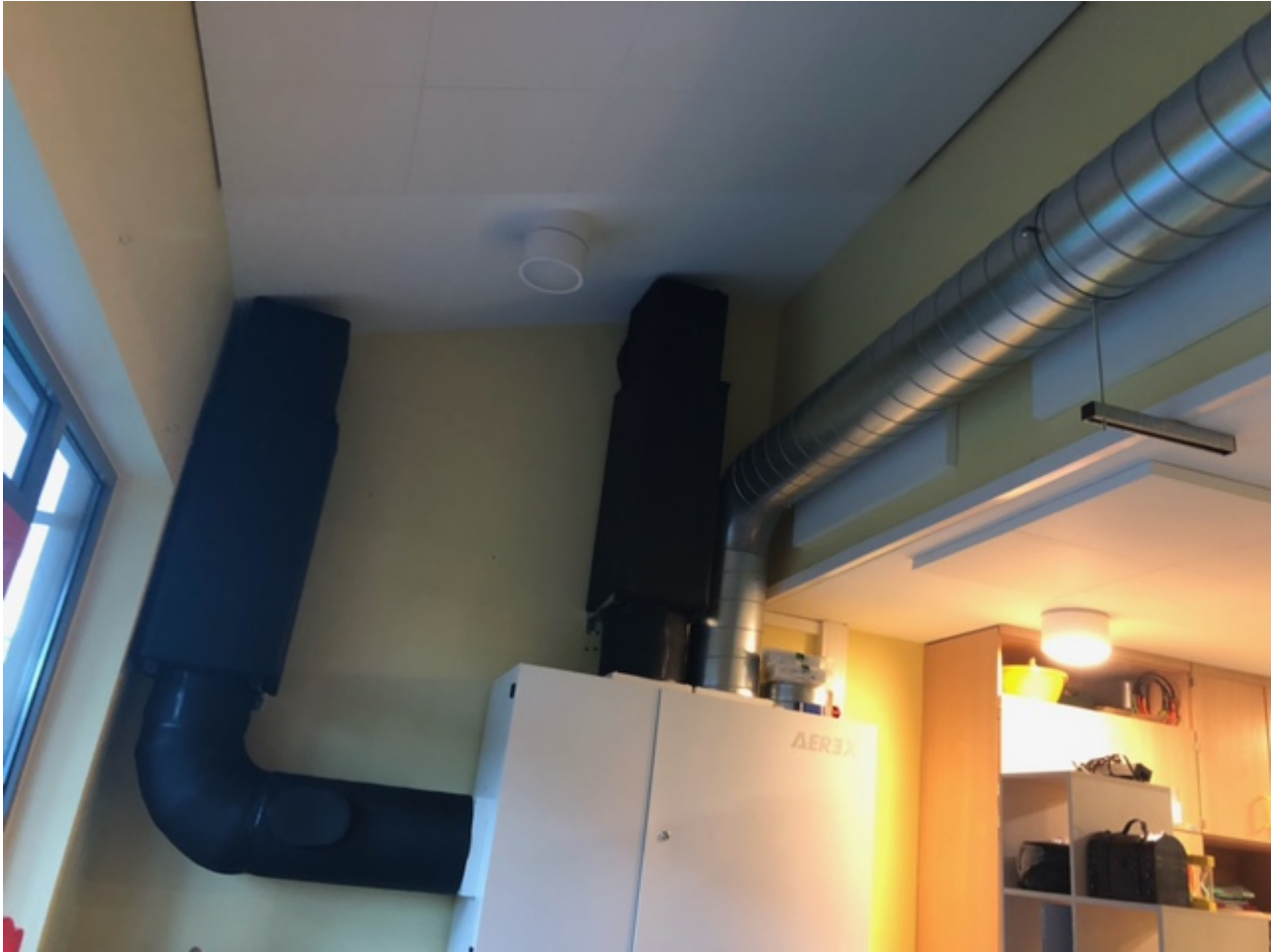
Ein Belüftungsungetüm und wenig Auslauf für Frösche
